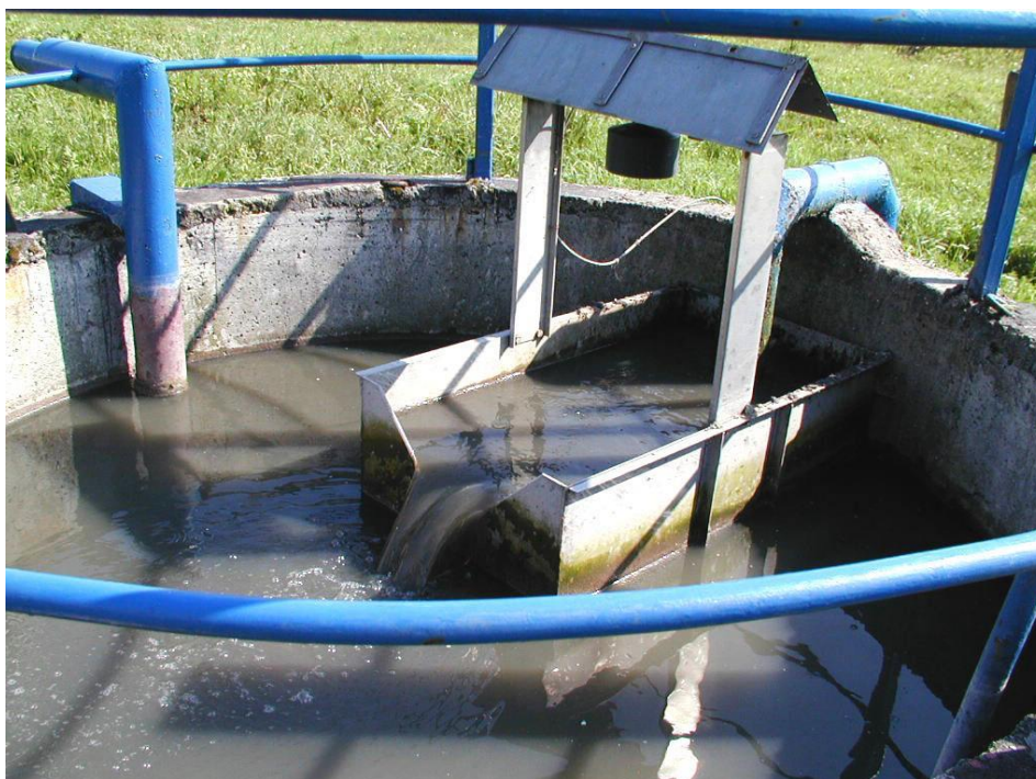
Ryc. 2. Zestaw pomiarowy przepływu ścieków zainstalowany w oczyszczalni w Koszycach
